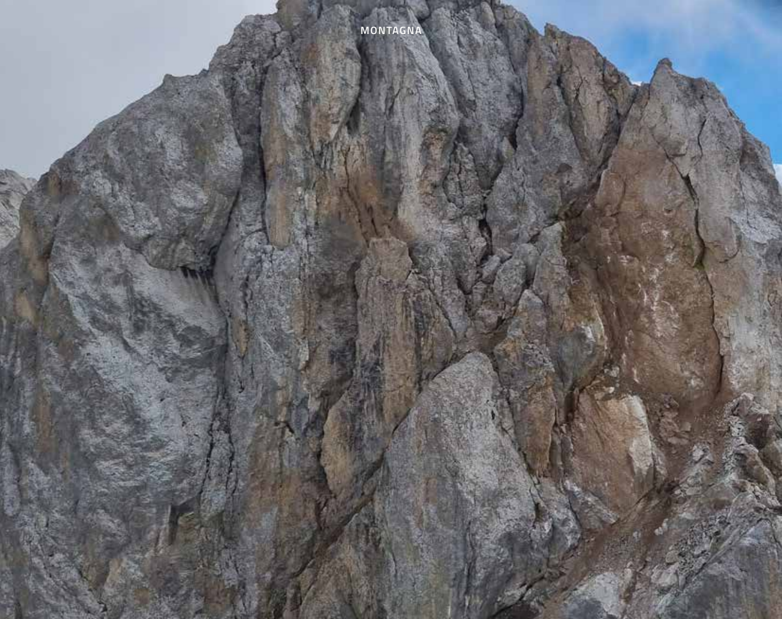
Cima Uomo, il crollo di oltre 100 metri cubi di materiale avvenuto il 16 agosto 2022
