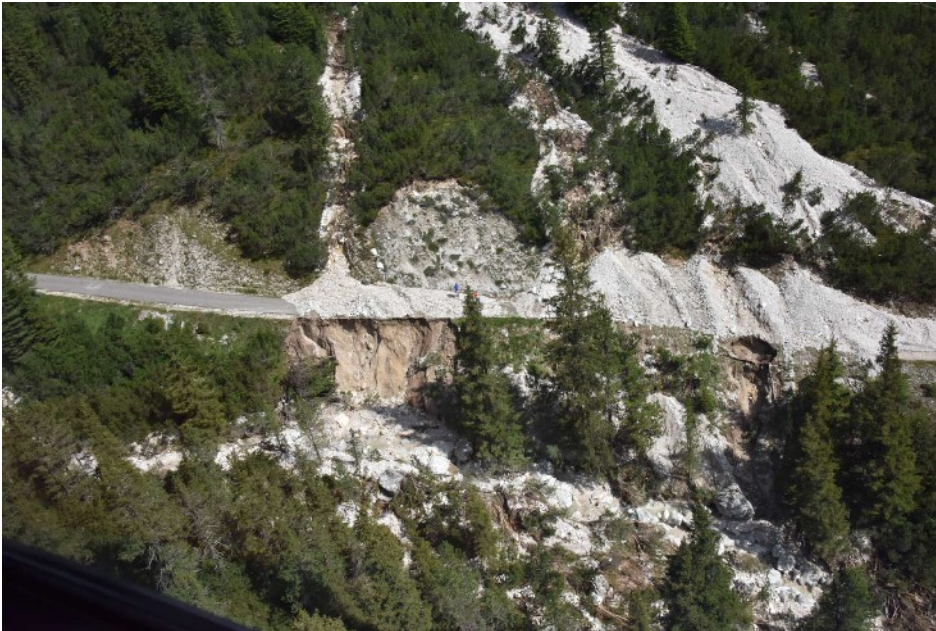
Strada del Gardeccia danneggiata (foto Servizio Prevenzione rischi)
